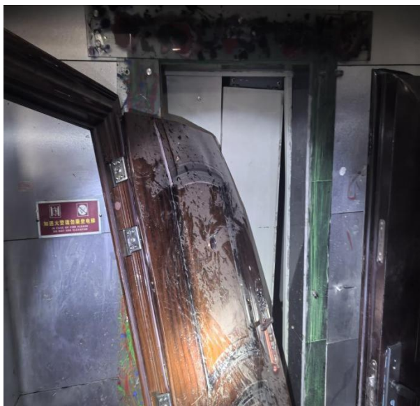
图 1-1 117 栋 1 单元 301 室入户防盗门轰燃后现场照片
