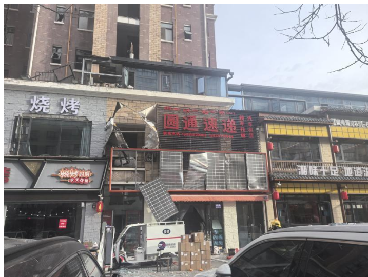
图 1-11 117 栋 1 单元 301 室厨房和北侧卧室外侧轰燃后现场照片
