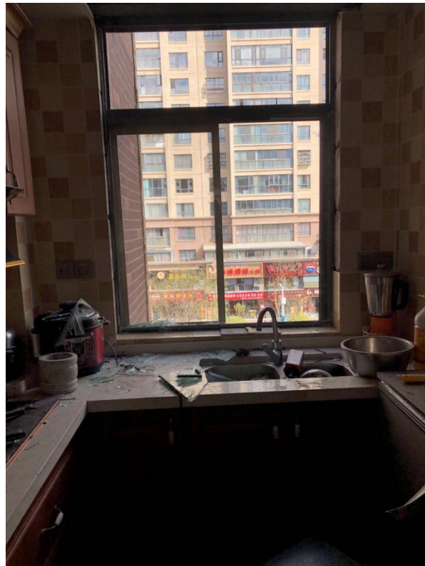
图 1-13 117 栋 1 单元 401 室厨房在轰燃后现场照片
