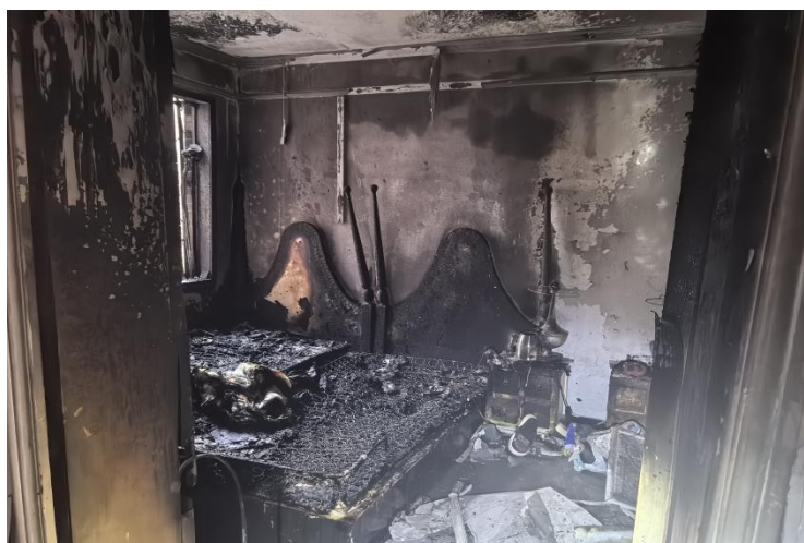
图 1-3 117 栋 1 单元 301 室北侧卧室轰燃后现场照片
