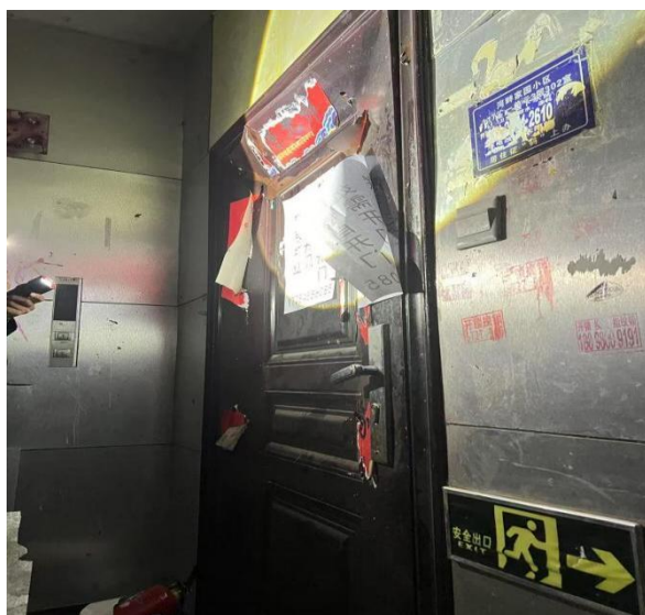
图 1-2 117 栋 1 单元 302 室入户防盗门轰燃后现场照片
