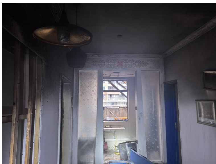
图 1-6 117 栋 1 单元 301 室客厅（面向北侧厨房方向）轰燃后现场照片
